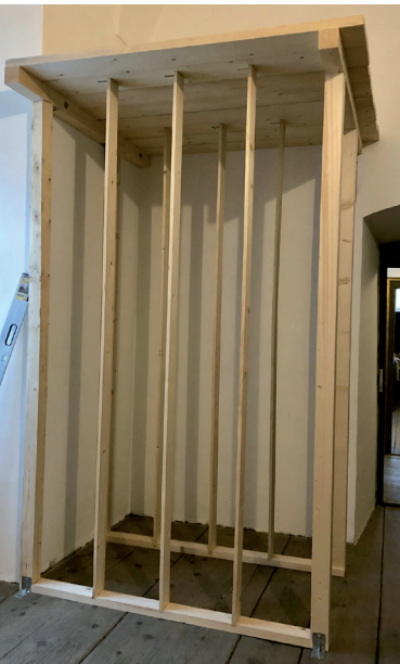
Abb. 9: Depotkonstruktion für großformatige Kreuzwegstationen mit begehbarem Gang an der Rückseite. Karmelitenkonvent Linz (Foto: Barabas)
